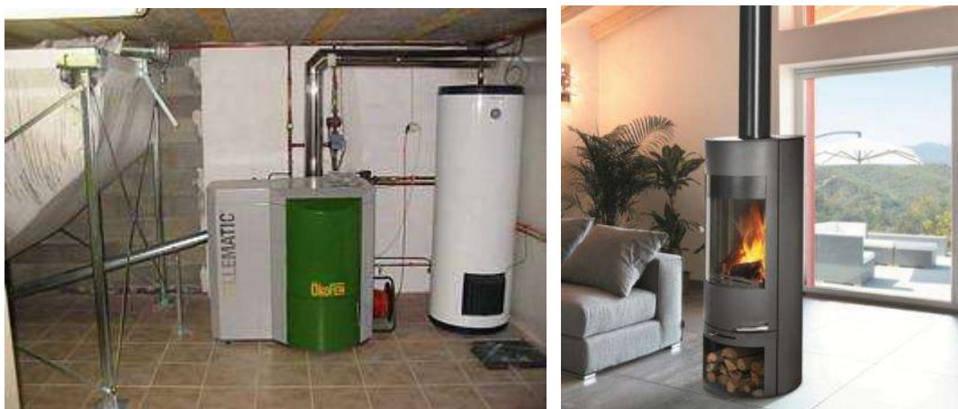
Chaudière et poêle à bois (Sources : HESPUL / Brisach)
