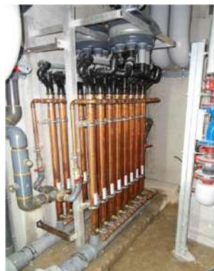
Exemple d'installation (Source : Gaïa Green)
